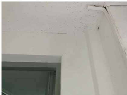
<관리실 내부 벽체 균열>
