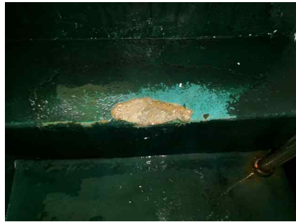
<배수지 1지 계단부 파손>
