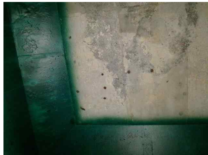
<배수지 1지 상부슬래브 녹>
