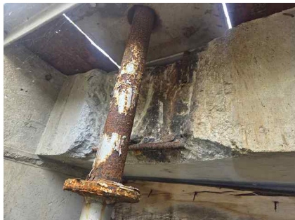
<유입밸브실(2지) 상부슬래브 파손 및 철근노출>
