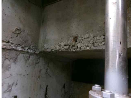
<유입밸브실(1지) 상부슬래브 재료분리>
