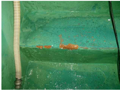
<배수지 1지 계단부 파손>
