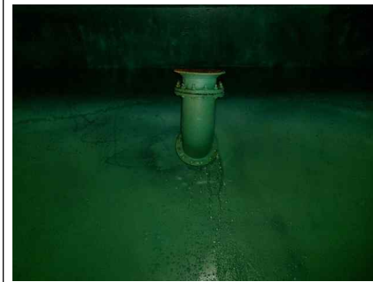
<1지 유입배관 상태양호>
