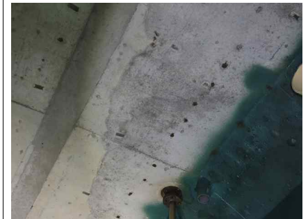
<배수지 2지 상부슬래브 녹>
