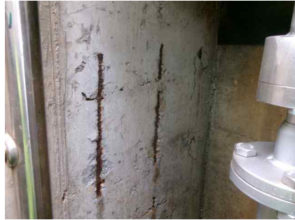
<유입밸브실(1지) 벽체 철근노출>
